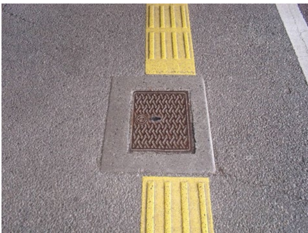
図-3 マンホールによる連続性の欠如③
