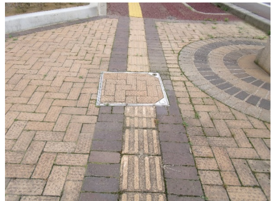
図-1 マンホールによる連続性の欠如①
