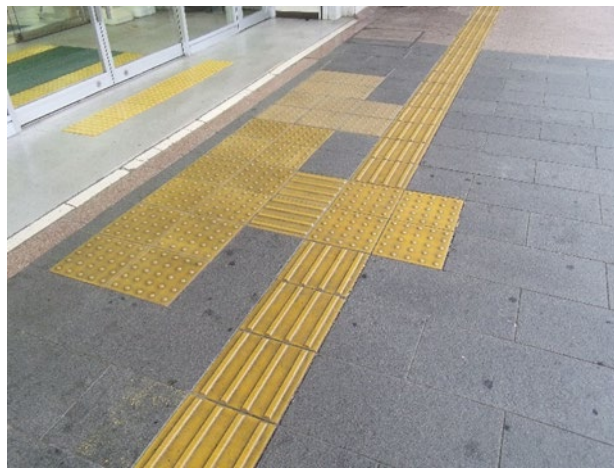
図-14 必要以上に設置された警告ブロック
