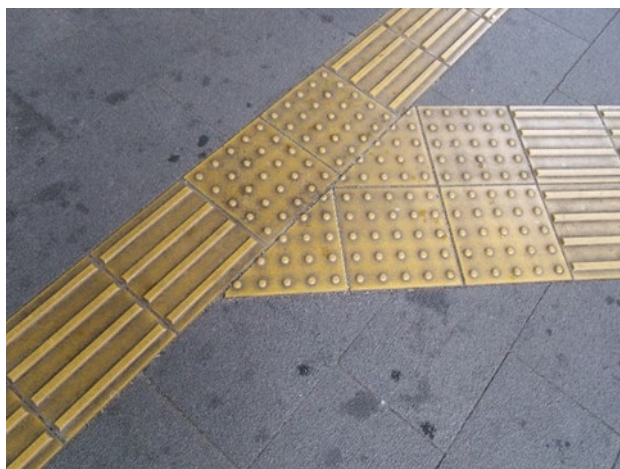
図-12 警告ブロックの重なり状況
