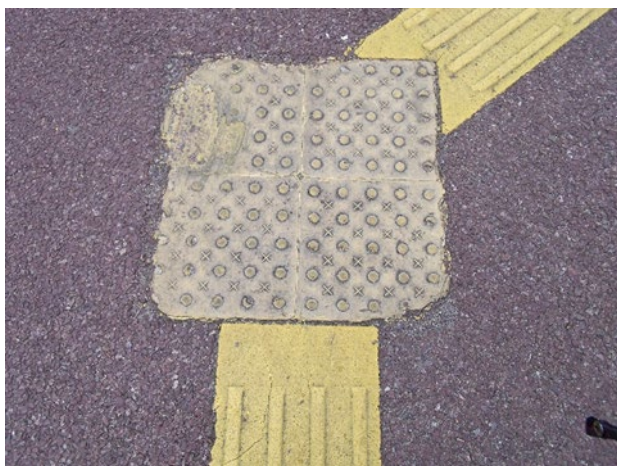
図-10 異なる材質と破損の状況
