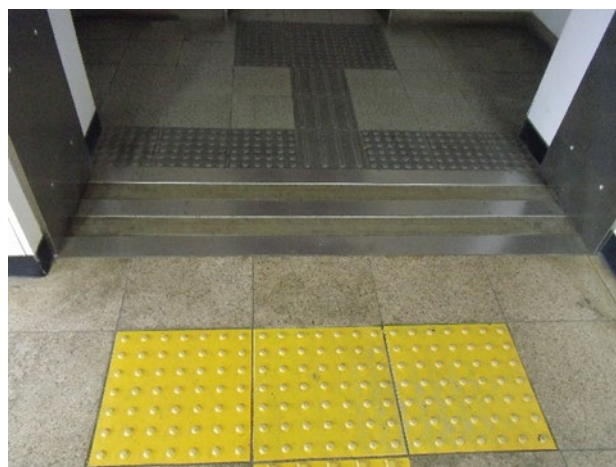
図-7 ジョイント部の連続性欠如
