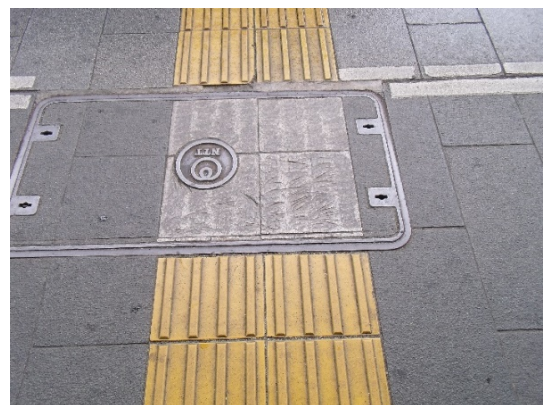
図-2 マンホールによる連続性の欠如②
