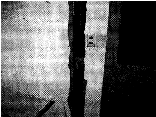
写真-15. 地震直後の校舎3号館1階廊下の亀裂
