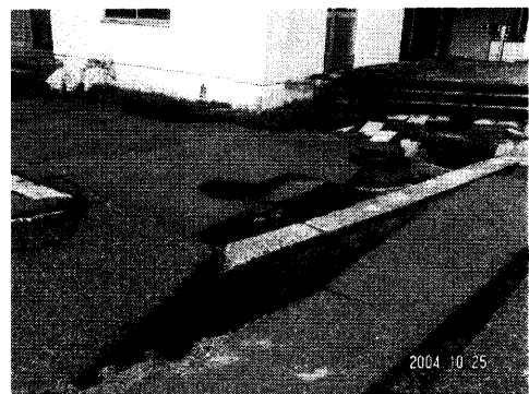
写真-9. 校舎3号館と学生食堂間のクラック
