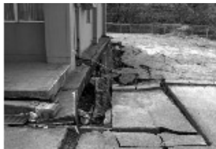
学生寮食堂周辺の陥没
