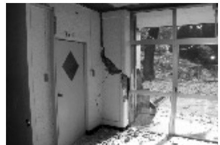
学生寮食堂前ホールの柱のせん断破壊
