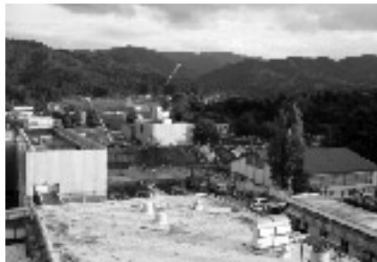
構内のいたるところが工事中、手前：図書館、左側：校舎2号館、奥側：雪氷センター、右側：第2体育館
