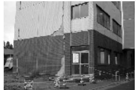
校舎6号館のタイルの剥落
