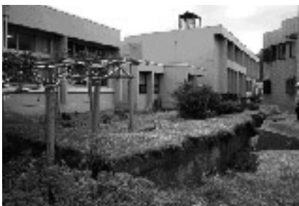
情報処理センターと福利施設棟の間に生じた地割れ
